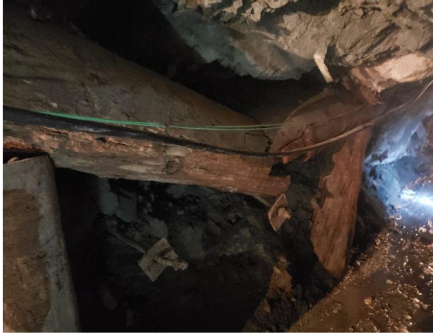
Anexo 1.- E0+170 m, Viga de madera rota, producto de los esfuerzos.
